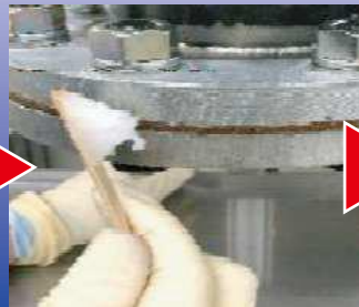
② 漏油箇所に塗布
