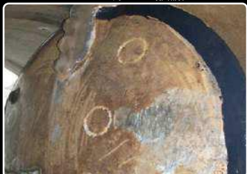
バタフライ弁のゴム部補修
